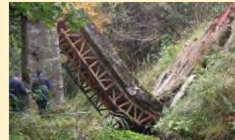
香川・徳島県境無名橋の落橋 (2007年)
